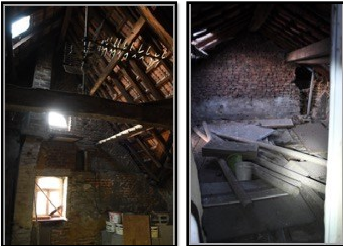
Abb. 20/21: Blick in den Dachstuhl des Gebäudes 8 mit zerbrochenen Fensterscheiben (li.) und der Dachstuhl des Gebäudes 7 (re.)
